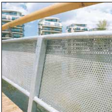
Lamiere forate inchiodate al telaio metallico di un ponte.
